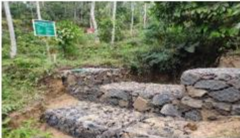
Pemasangan DAM penahan merupakan salah satu kegiatan RHL dengan cara sipil teknis
