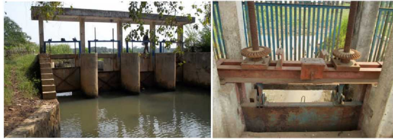
Gambar 4 Pintu skot balok
