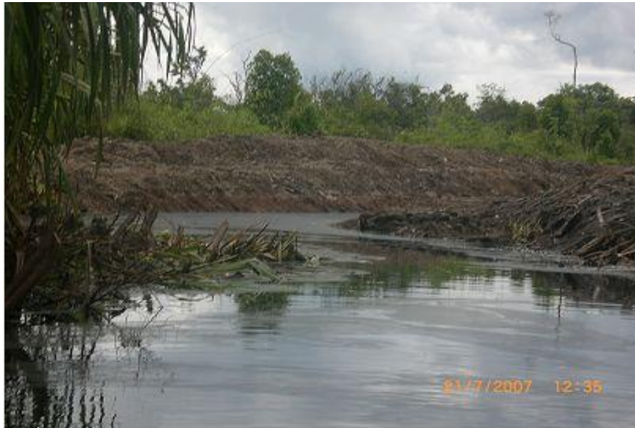
Gambar II-4. Pembuatan kanal saluran drainase ke Sungai Mantangai pada ekosistem hutan gambut tebal
