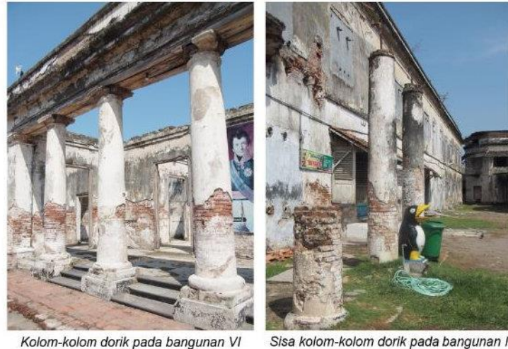
Gambar F.21 Sisa Kolom pada bangunan
