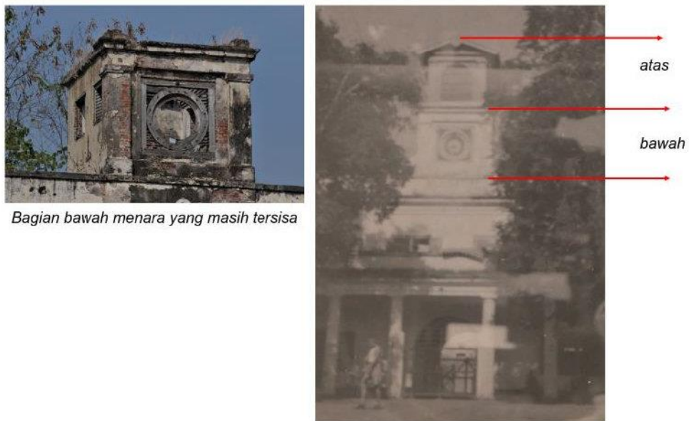
Gambar F.29. bagian menara yang masih tersisa
