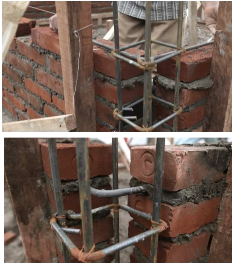
Gambar 47. Pemasangan Angkur Besi Sebagai Pengikat Antara Kolom dengan Dinding Pada Sudut Bangunan
